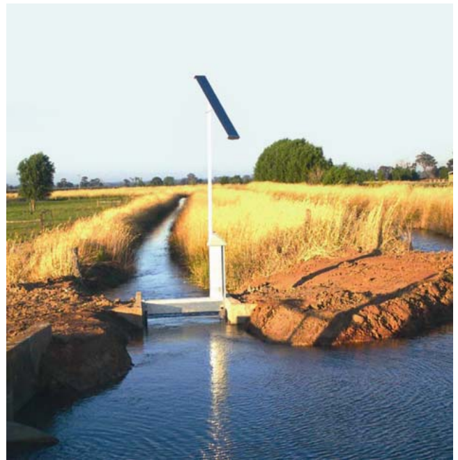
Abbildung 1: Den Strom erhalten die Wasserschleusen aus Solarzellen
